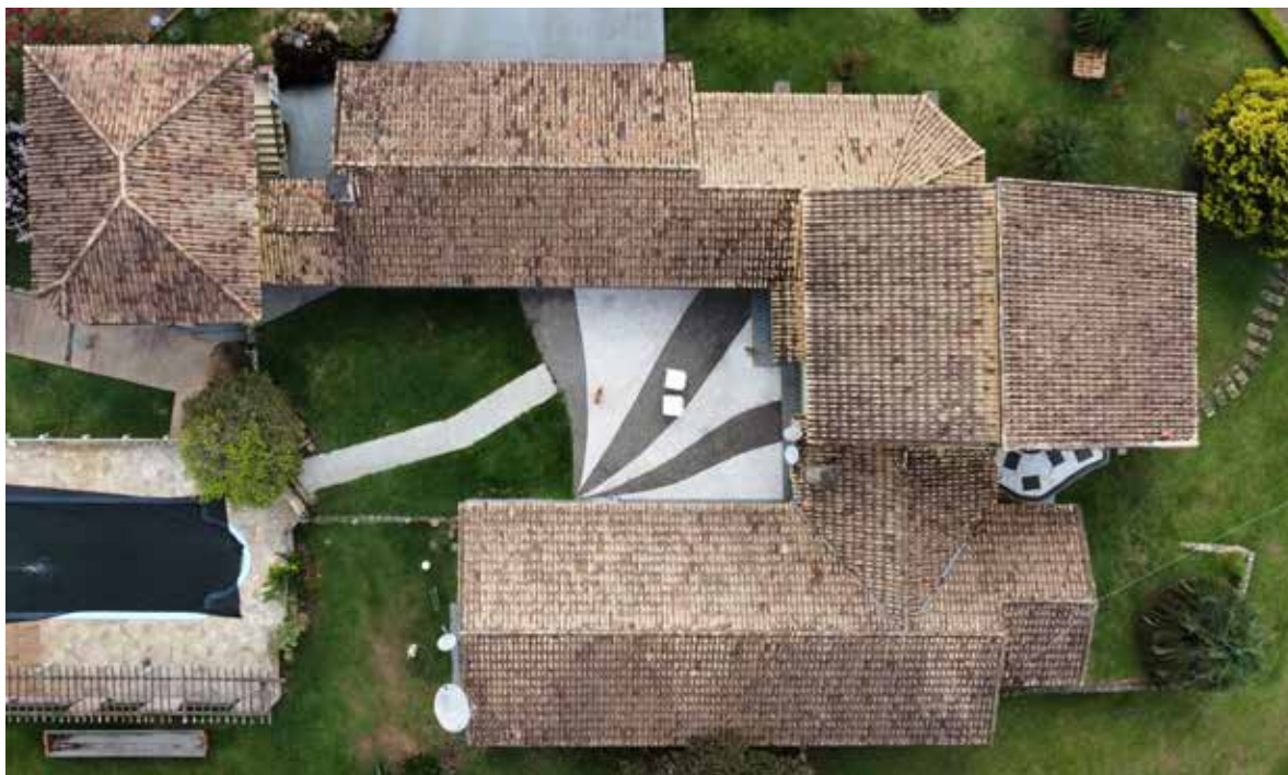
Figura 21 — Telhado Residencial antes
